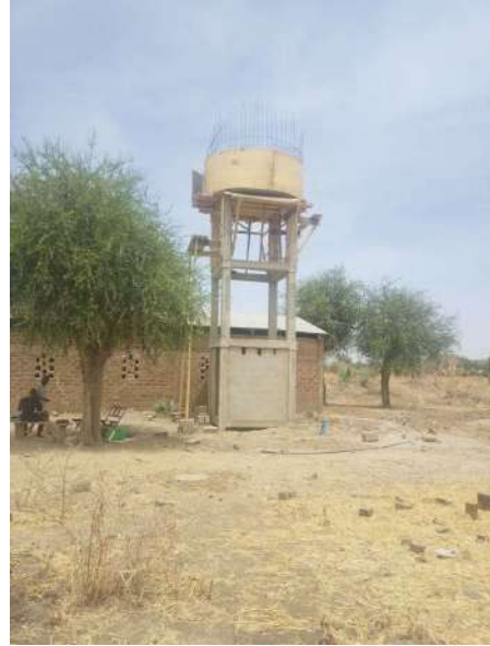
Travaux de construction d'une mini AEP à Bangala, Commune de Guémé, Département du Mayo Danay
