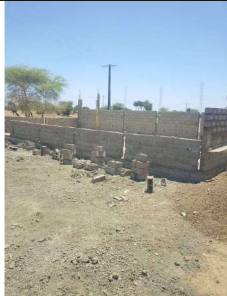
Travaux de construction d'un magasin de stockage à Dabaye 2, Commune de Guémé, Département du Mayo Danay
